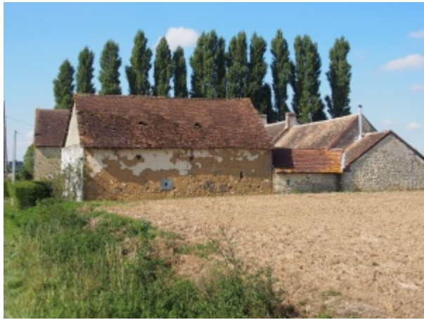
Dépendance agricole en bauge, Avesnes-en-Saosnois - Photo Patrick Dejust - Maisons Paysannes de la Sarthe.
