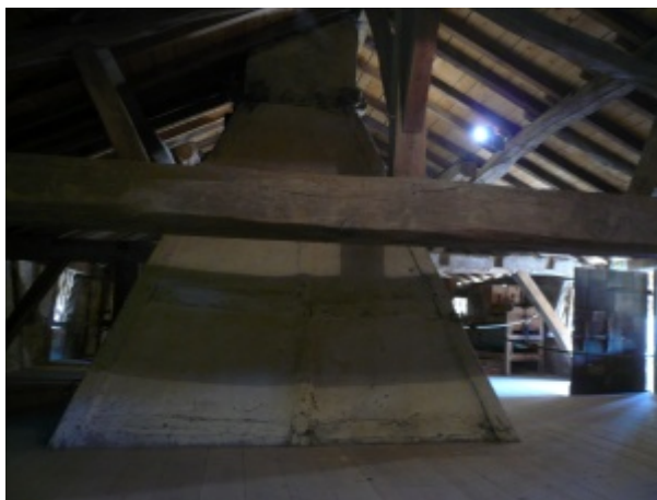
Conduit de cheminée traversant les combles dans la ferme du Champ-Bressan, actuel Musée du terroir, Romenay (71).
