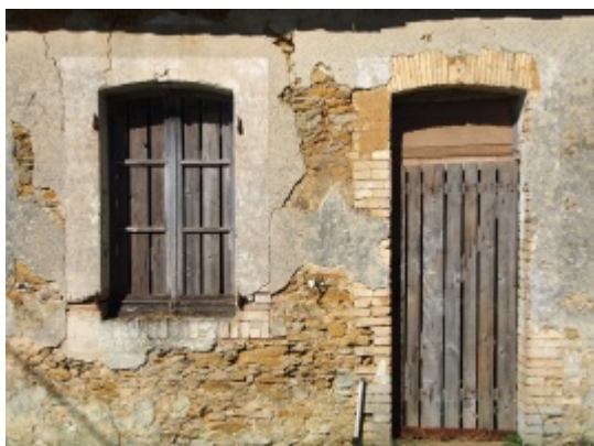
6 - Maison entièrement enduite et décorée à l'origine de cadres tracés à la chaux, à Courceboeufs.
