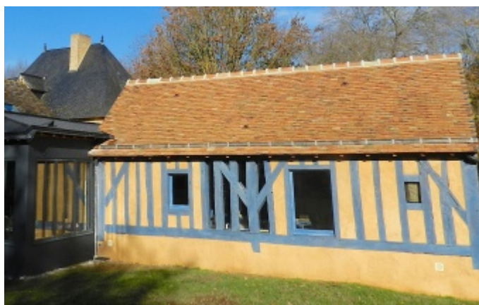
Les pans de bois ajourés apportent une lumière supplémentaire et offre une vue sur le jardin.
