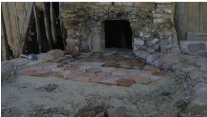
Surface plane de la sole avec carreaux posés sur un mortier. La bouche du four est déjà existante sur un des murs de la maison.
