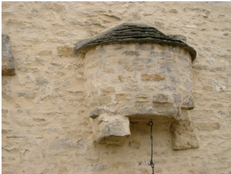
Vue extérieure d'un four suspendu maçonné et couvert de lauzes à Gissey-sous-Flavigny (21).
