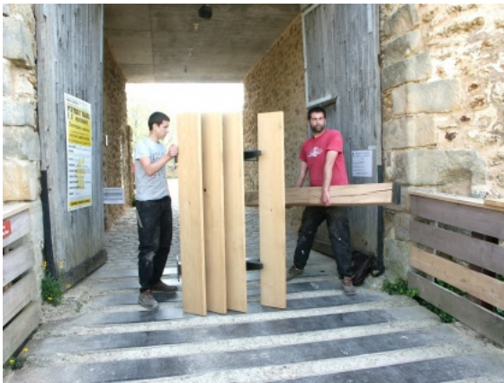
Réalisation d'un prototype de claustras sur le chantier. Photo PNRHV © Maisons Paysannes de France, Concours René Fontaine 2014-2015.
