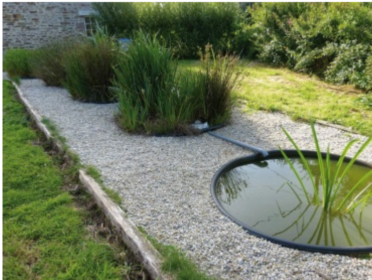
Bassins de phytoépuration pour eaux grises.
