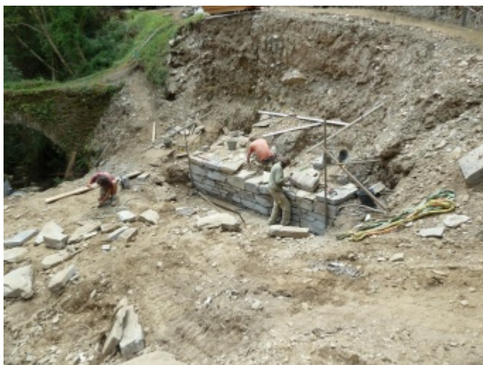
Construction des fondations du pont. Photo Maisons Paysannes de France - Prix René Fontaine ©
