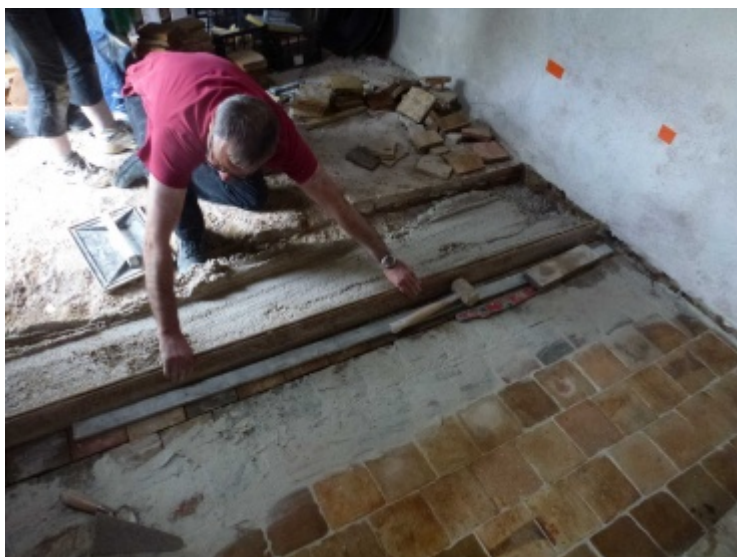
Réalisation de la chape à l'avancée avant pose de carreaux à joints décalés, coulés à la barbotine.
