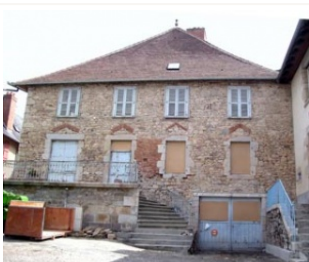
Le piquetage a fait ressortir les arcs de décharge ainsi qu'un garnissage en briques à rhabiller. La couverture a été refaite en tuiles locales de Puycheny.
