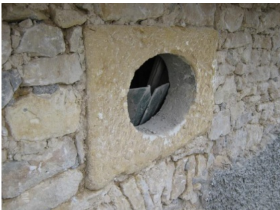
Oculus découvert sous enduit ciment. Photo D. & L. Guillemain © Prix René Fontaine de la Maison de Bourg.
