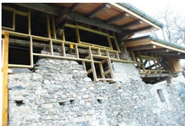
Pose d'une ossature en bois en partie haute du chalet sur laquelle seront posés les bardeaux de bois.
