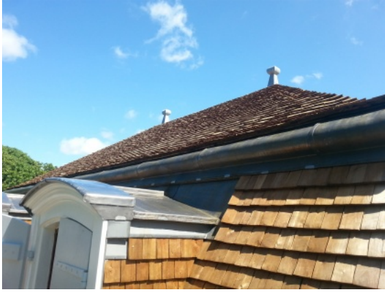
Toit couvert de bardeaux après travaux. Photo Pierre Danielczak © Prix René Fontaine 2018.
