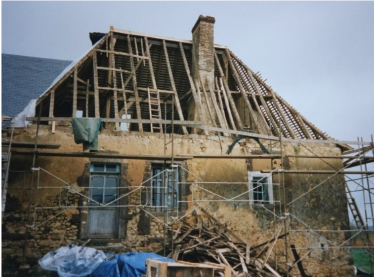
Charpente du logis avant de restaurer la couverture. Photo Gérard Gasnier © Maisons Paysannes de France, Prix René Fontaine.
