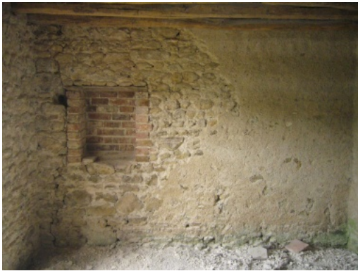
Murs intérieurs de la loge de vigne dont l'enduit est dégradé. Photo Claudie Plisson © Maisons Paysannes de France, délégation Maisons Paysannes du Loiret.
