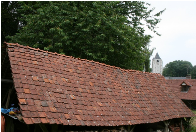
Pannes faîtières à recouvrement de 2,5 rangs, situé à St Maulvis. Photo Jean-François Herlem © Maisons Paysannes de France, Délégation de la Somme.
