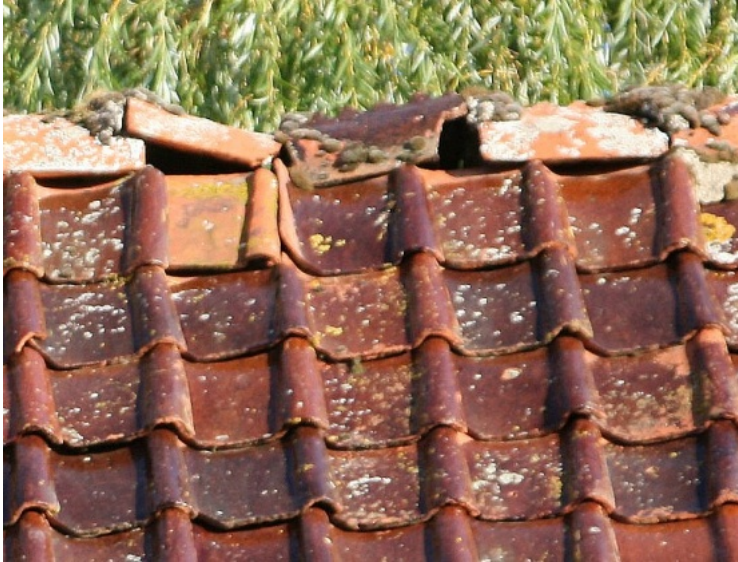
Reste de panne faîtière vernissée à Selincourt, ferme de Ste Larmes. Photo Jean-François Herlem © Maisons Paysannes de France, Délégation de la Somme.
